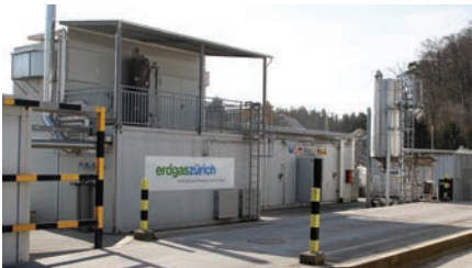
Die Anlage der Erdgas Zürich produziert rund 10 GWh Biogasenergie, mit der rund 500 Haushalte versorgt werden können.
