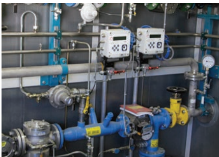
Der Übergang von Biogas zu Erdgas: Ein Zähler kontrolliert die ins Netz gespiesene Menge, welche steuerlich bevorteilt wird.
