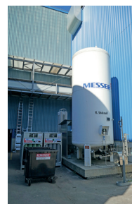
Während der Prüfung wird in der Regel Stickstoff verwendet. Dieses muss in grösserer Menge verfügbar sein. Es kommt auch Kohlendioxid oder in seltenen Fällen R134a zum Einsatz.
