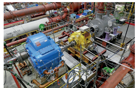
Der Antrieb dieses Kompressors erfolgt über einen Elektromotor via zwei Getriebe. Die Antriebsleistung der Elektromotoren kann 16 MW betragen.
