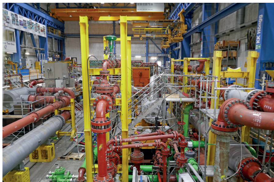
Wer sich Prüfstände der Fahrzeugtechnik gewohnt ist, wird in der Prüfhalle A der Everllence staunen. Die Dimensionen und das Gewirr von Rohren und Kabeln lassen den Aufwand für eine Prüfung erahnen.
